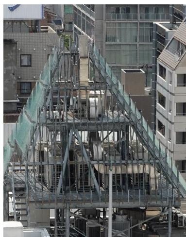
【本社】 脱臭装置
