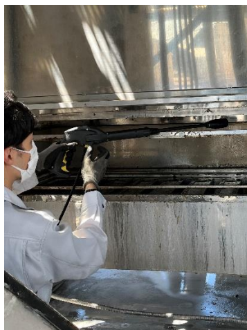
排気脱臭処理システム 清掃状況
