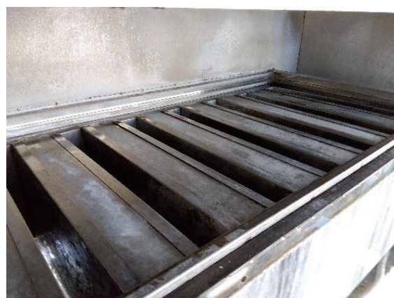
脱臭フィルター 洗浄後
