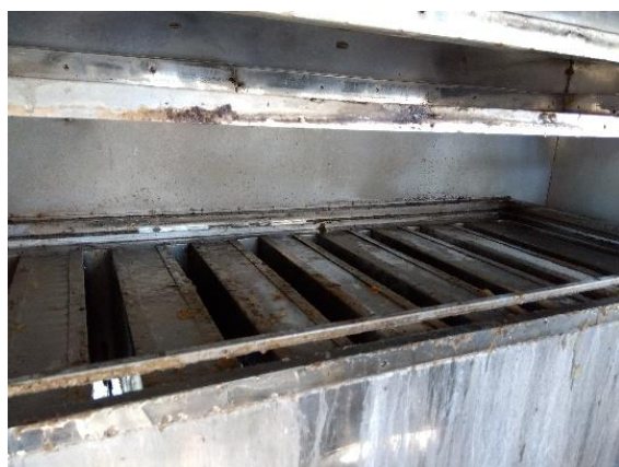
脱臭フィルター 洗浄前
